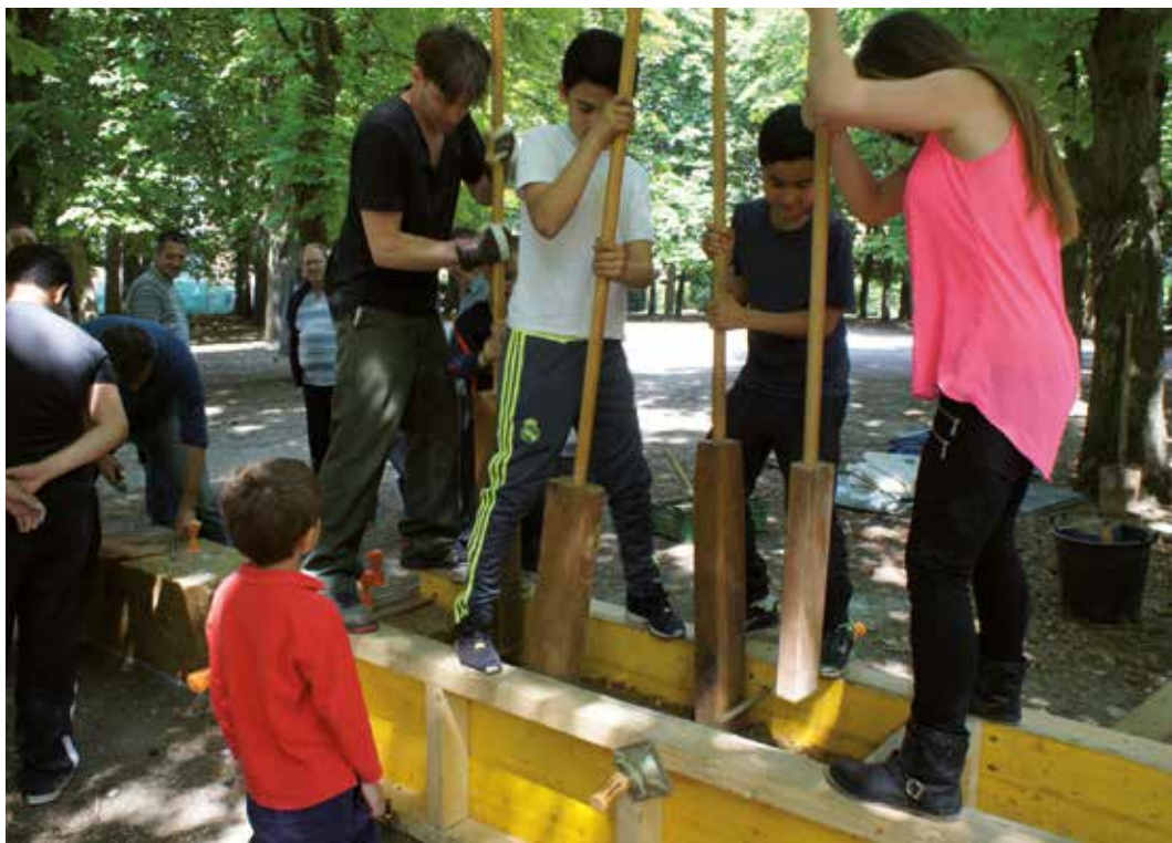
Chantier en cours avec les habitants de la cité, Bobigny, France - photo: Michèle Renard, juin 2015
